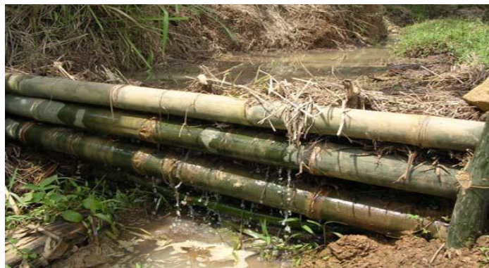
Gambar 43. Bangunan terjunan air (BTA) dari bambu
