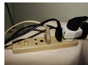
Gambar 1.29 Sambungan Kabel Listrik pada Stopkontak Perlu Diperiksa Sebelum Digunakan dalam Praktik di Laboratorium Foto: Dokumentasi Penerbit
