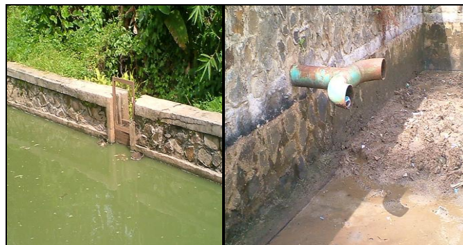
Gambar 85. Pipa Pemasukan dan Pengeluaran Air
