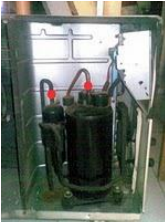
Gambar 4.2 Kompresor AC Split
