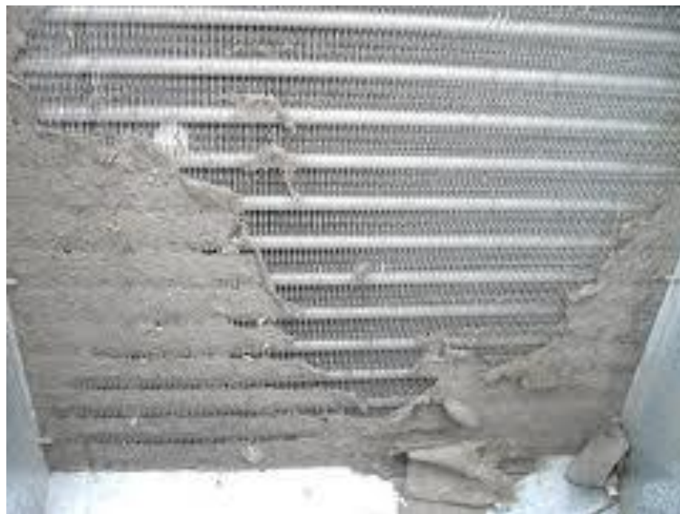
Gambar 3.2 Kondisi Koil Kondensor Sangat Kotor
