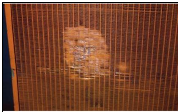
Gambar 10.90 Fin radiator mengalami kerusakan
