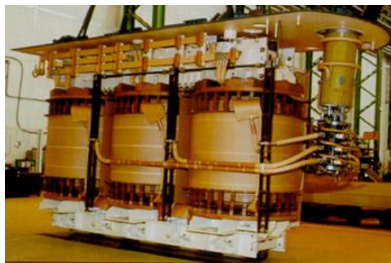
Gambar 5.22 Trafo Daya Besar
