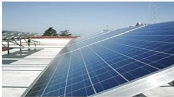
Panel Solar sebagai pembangkit listrik alternatif
