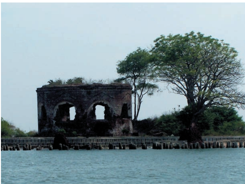
■ Benteng Mortello dari kejauhan, sayang kapal tidak dapat merapat karena kondisi dermaga yang rusak dan terdapat banyak kerang di sekitar dermana (2009)
