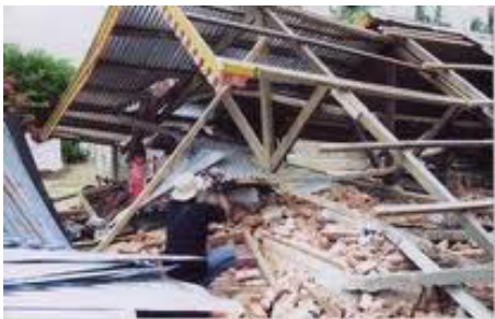
Gambar 2.48 Salah satu gedung sekolah yang rusak berat di Kabupaten Mukomuko (Sumber: Koleksi Zusneli Zubir)
