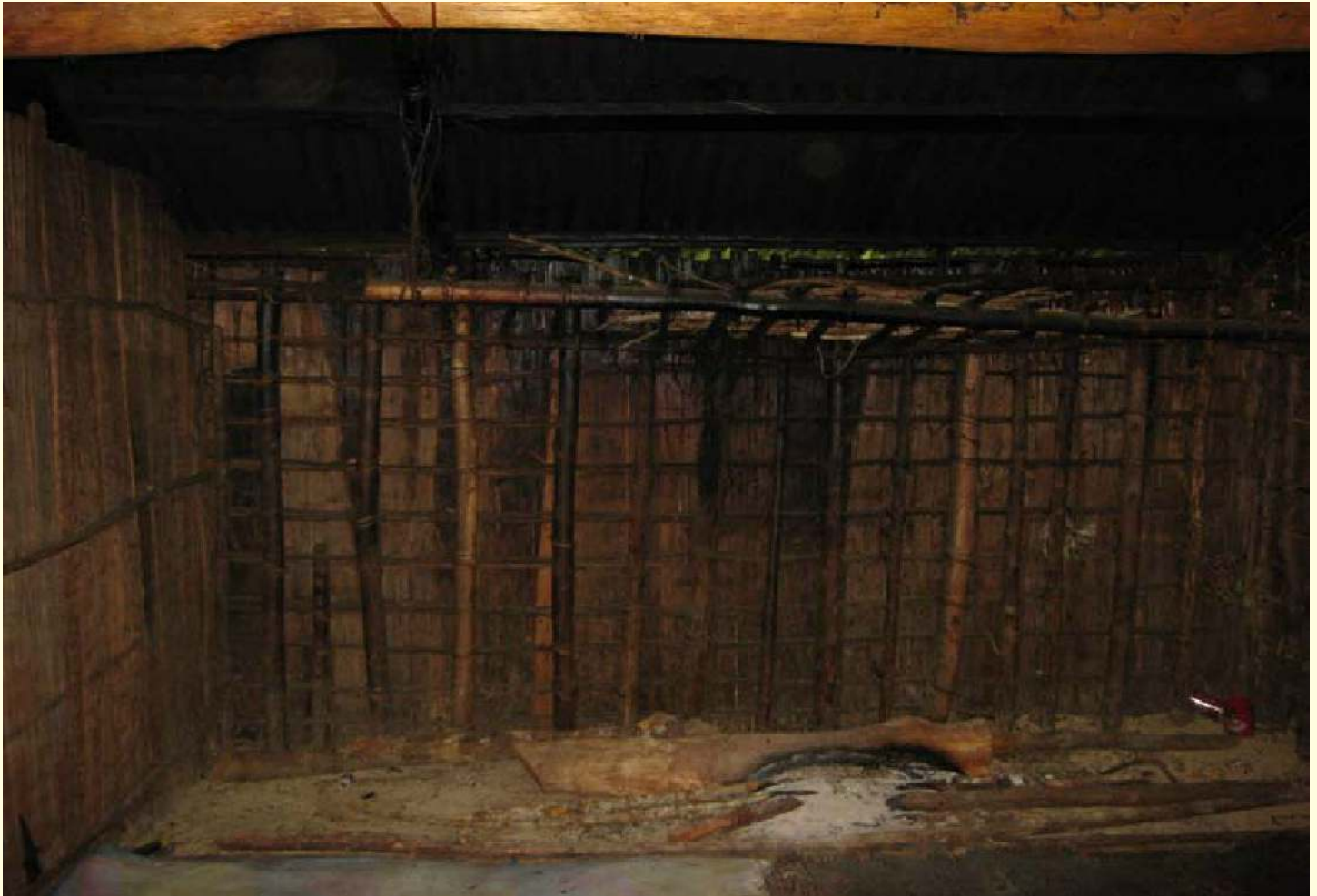
Konstruksi kayu-kayu ramping sebagai dinding rumah kaki seribu dilihat dari sebelah dalam rumah (Dok. Yuke Ardhiati, 2014)
